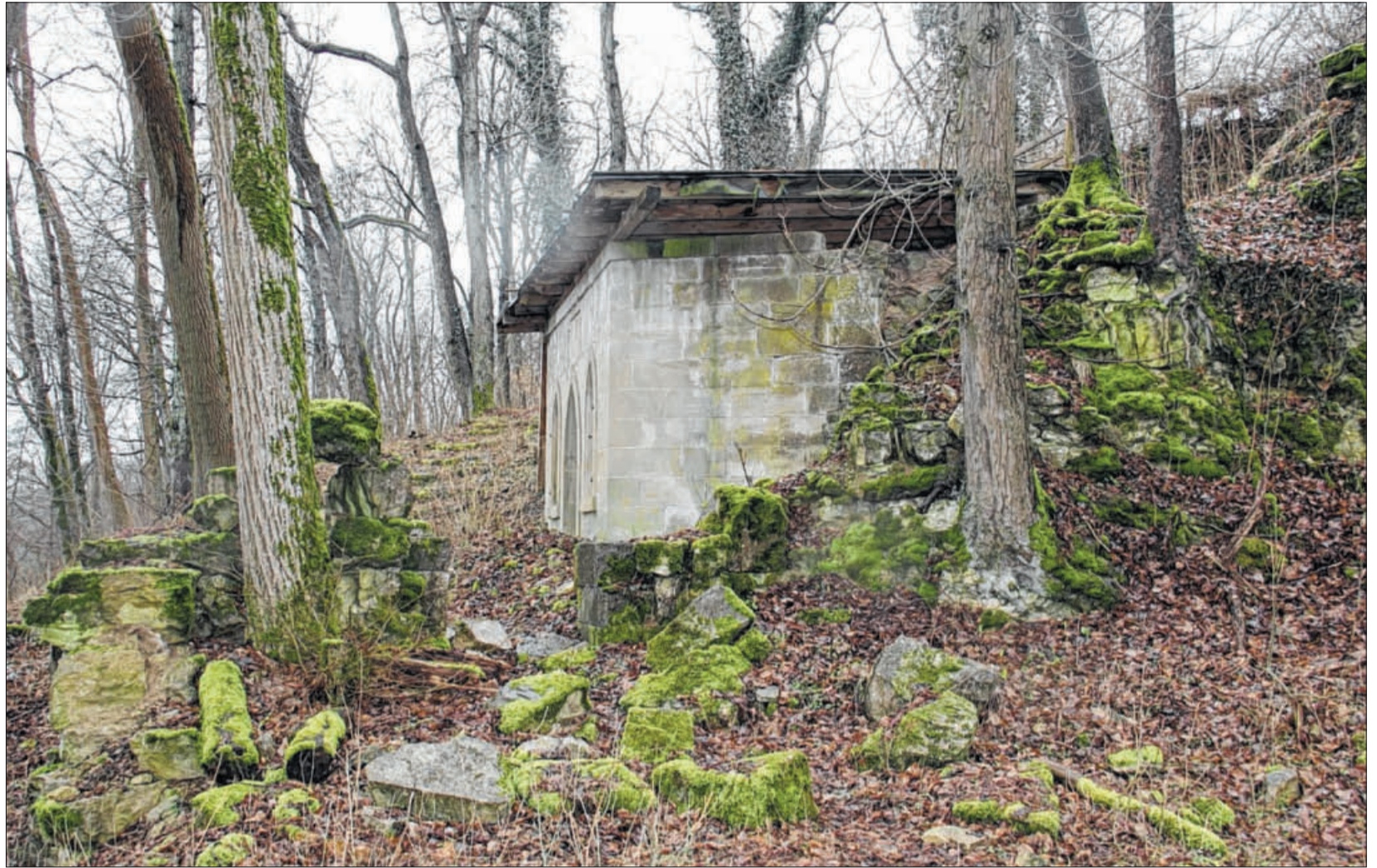
Vom ehemals zweistöckigen Teehaus ist nur noch ein Geschoss übrig. Es ist notdürftig mit einem provisorischen Dach abgedeckt.
